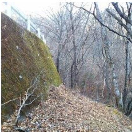
車道擁壁下の古道へは移行困難
