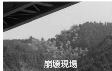
西武秩父線鉄橋下から見る吾野の崩壊現場 平成元年撮影
